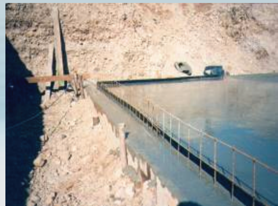
In den Frischbeton nachträglich eingedrückt
